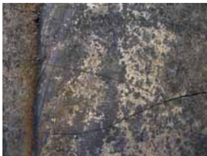
Poikittaisia halkeamia kovahitsiaineessa.
